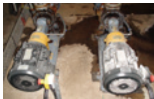
効率化工業用冷却水ポンプ
