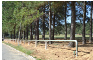
排水処理水の配水管
