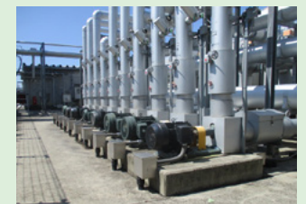
福島工場 冷却水ポンプ
