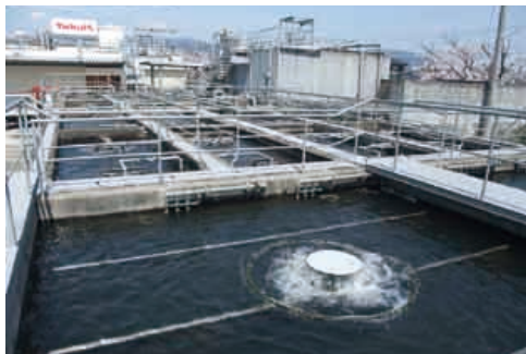
佐賀工場・水浄化システム
