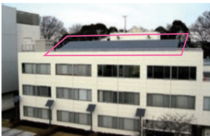
増設した太陽光発電システム
