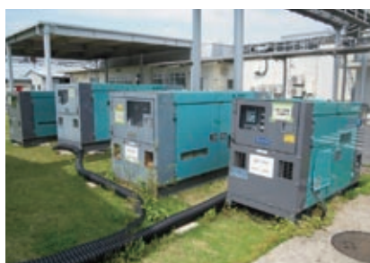
茨城工場 発電機
